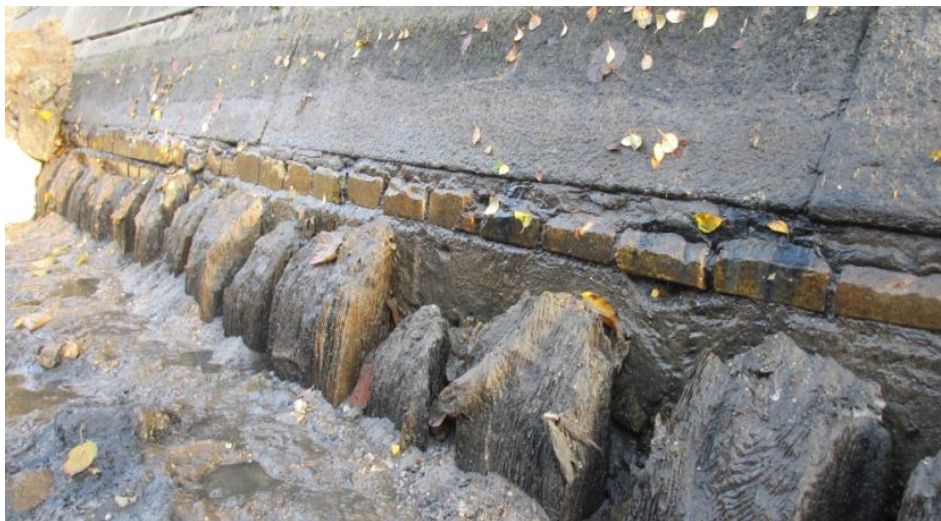
typisches Schadensbild mit korrodierter Holzspundwand und Ziegelflächenschicht
